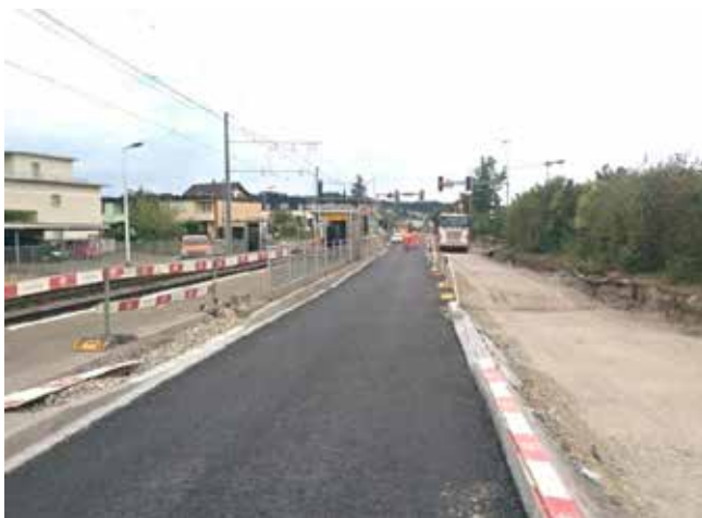
Haltestelle Reinach Süd mit neuem FG-Übergang
