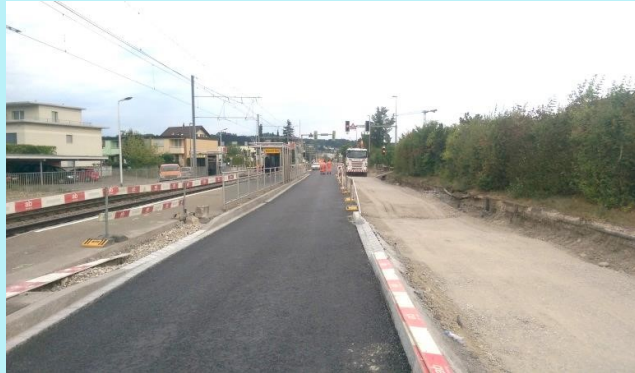
Haltestelle Reinach Süd mit neuem FG-Übergang
